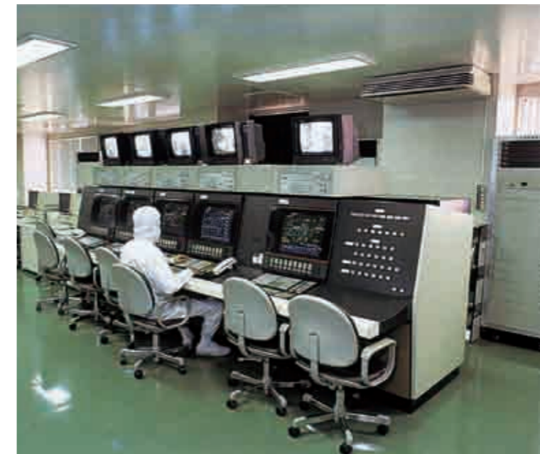
コンピューターによる運転・制御・監視 Facility controlled by computers
